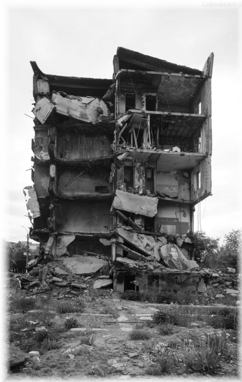
Фото 2. «Леся» мурал Крістіан Гемі, м. Бородянка, вулиця Центральна – той же будинок, зруйнований російськими окупантами. Автор: К. Чорноморець.
